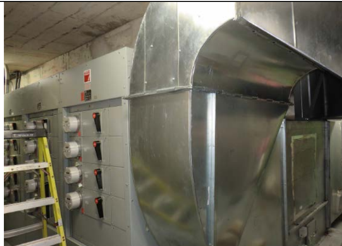
Photo 1 : Lieu de l'accident (Source : CNESST)
