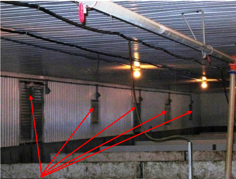
Photo 4 : ventilateurs au mur Source :CSST
