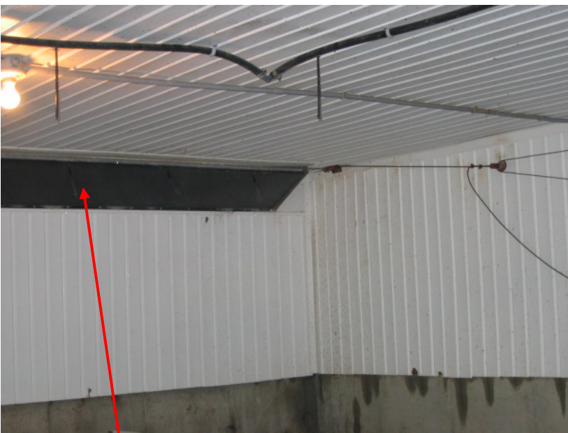
Photo 5 : trappe d'entrée d'air sur le mur opposé aux ventilateurs Source :CSST
