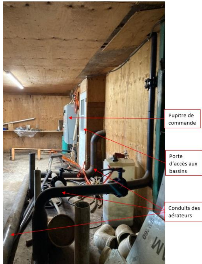
Fig. 7 - Photographie de la mezzanine de la rallonge Source : CNESST
