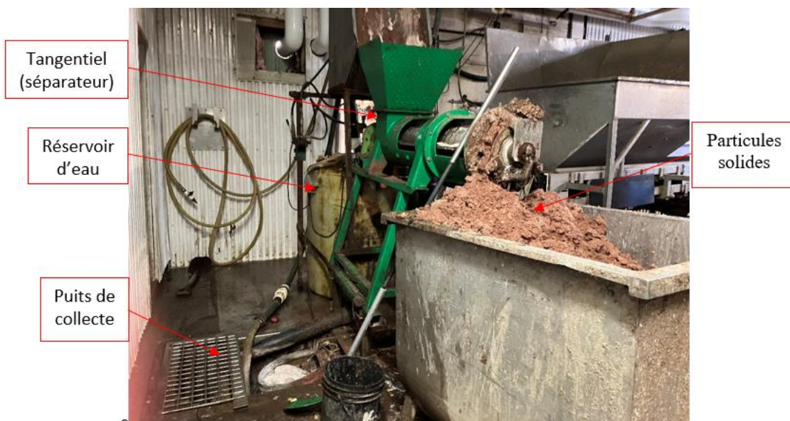
Fig. 12 - Photographie du local de séparation et récupération de l'eau Source : CNESST
