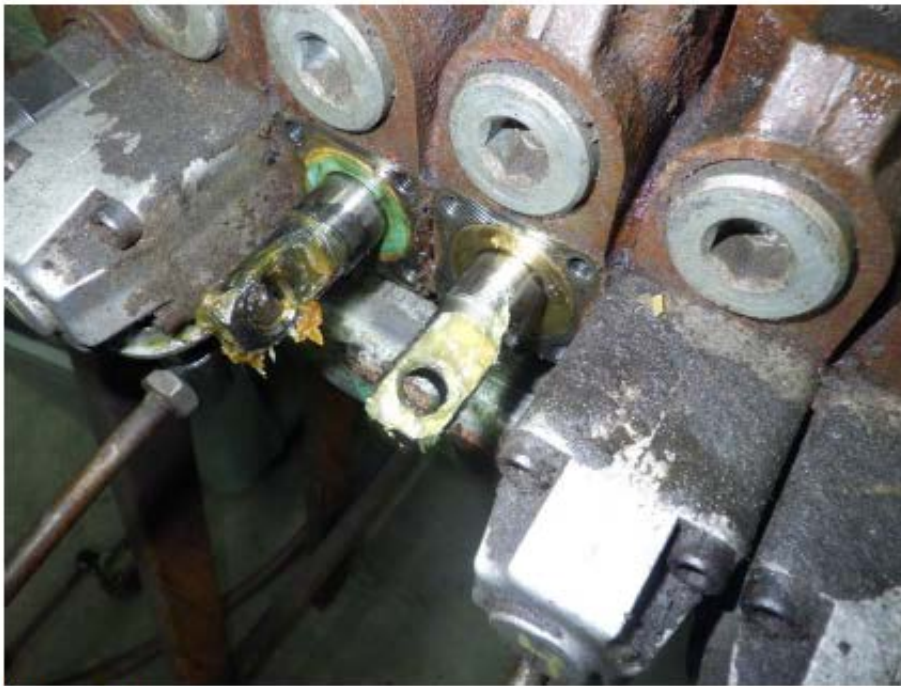
Photographie 15 Le mécanisme des leviers n o 2 et 3 étaient adéquatement graissés
