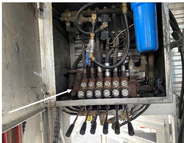
Fig. 25 : Bloc distributeur hydraulique et leviers de commande
