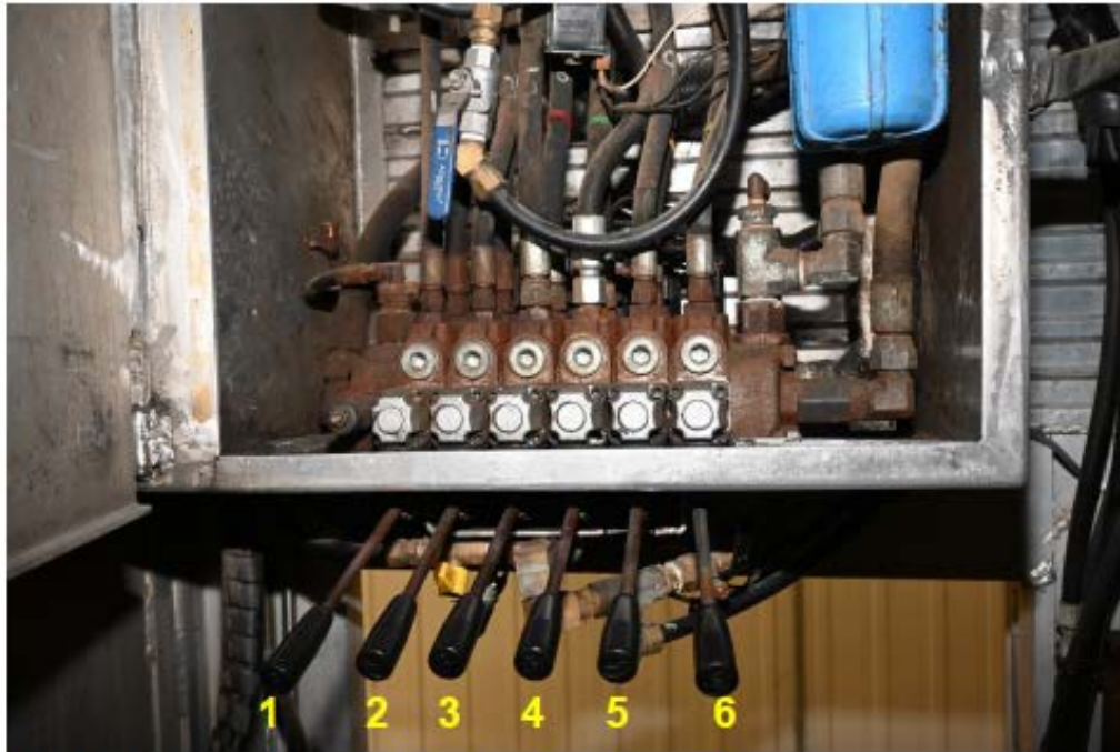
Photographie 7 Distributeur hydraulique installé à l'intérieur d'une armoire en aluminium et muni de six leviers manuels distincts
