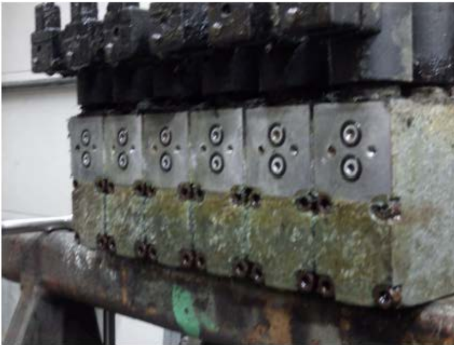
Photographie 18 Importante accumulation de corrosion entre les boîtiers en aluminium des actionneurs
