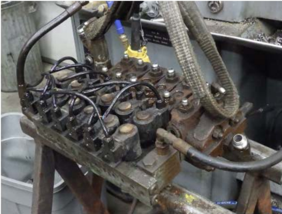
Photographie 16 Six actionneurs électrohydrauliques installés du côté opposé aux leviers manuels
