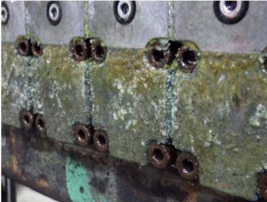
Photographie 19 Importante accumulation de corrosion entre les boîtiers en aluminium des actionneurs
