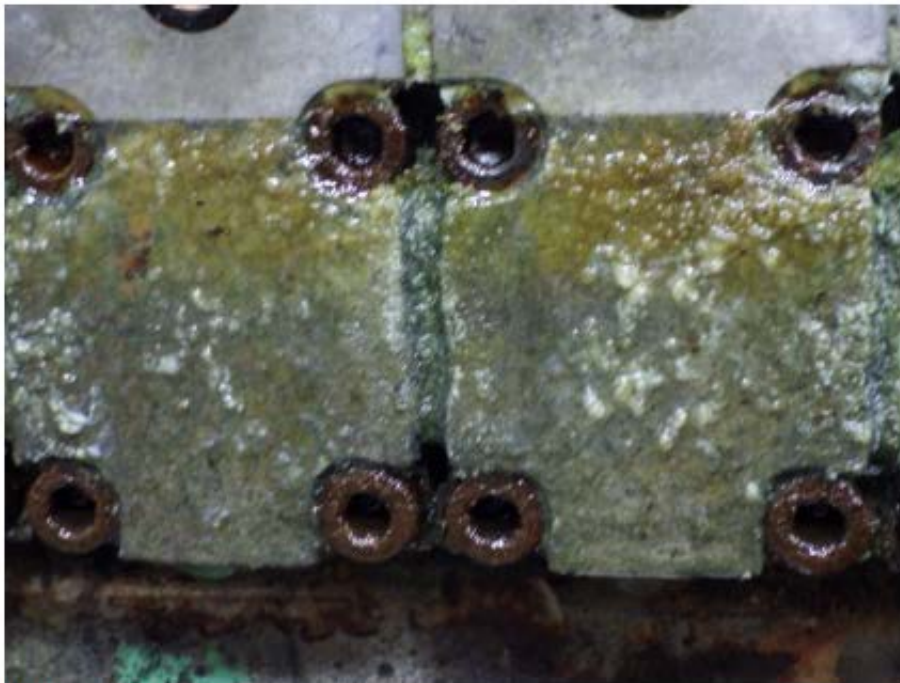
Photographie 20 Les parois latérales des boîtiers en aluminium semblaient avoir été déformées par l'accumulation de corrosion
