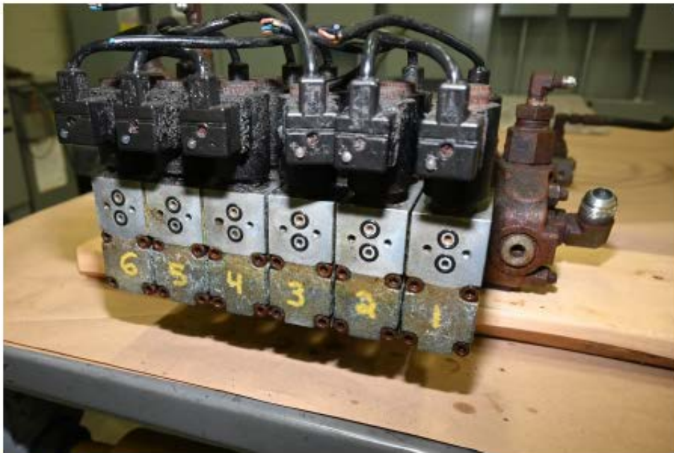
Photographie 39 Boîtiers des six actionneurs électrohydrauliques
