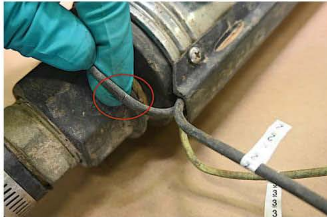
Fig. 13 - Fissure dans la gaine d'un conducteur relié à la pompe
