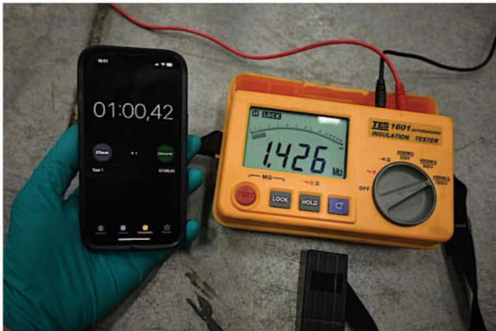
Photographie 5 Test au mégohmmètre
