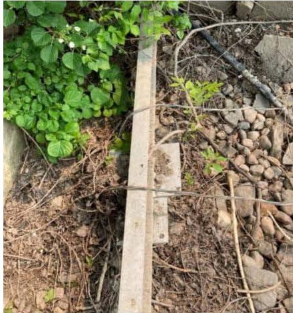
Fig. 11 - Conducteurs de la pompe coincés dans la poutre en bord de rive
