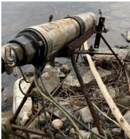
Fig. 6 - Pompe sur son support Source : CNESST
