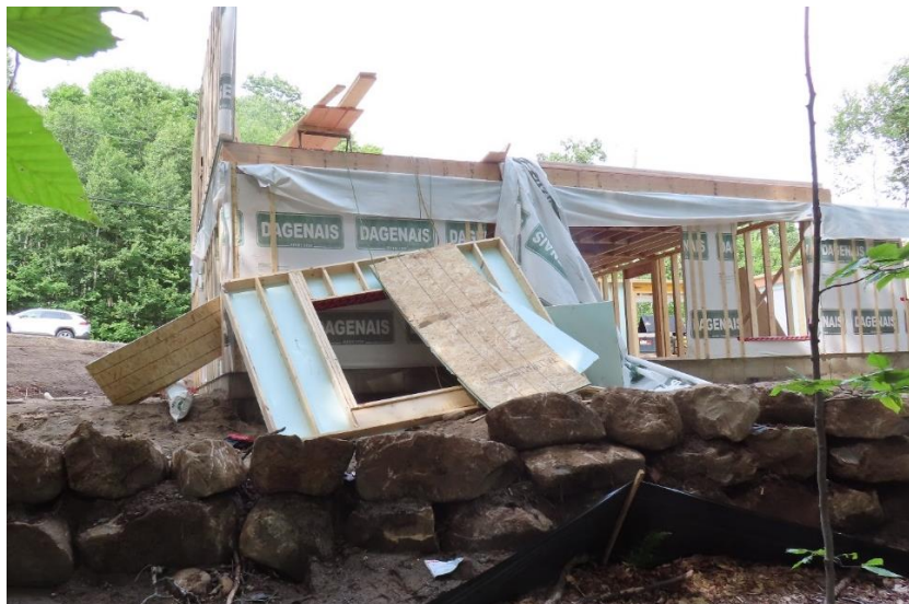
Figure 1 : Lieu de l'accident
