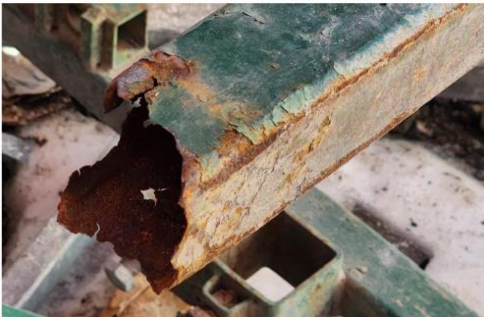
Photo 6 - Deuxième membrure rompue avec des traces de corrosion avancée (source CNESST)
