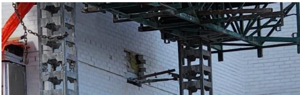
Photo 10 - Barre d'ancrage rompue de l'unité mobile droite (source CNESST)
