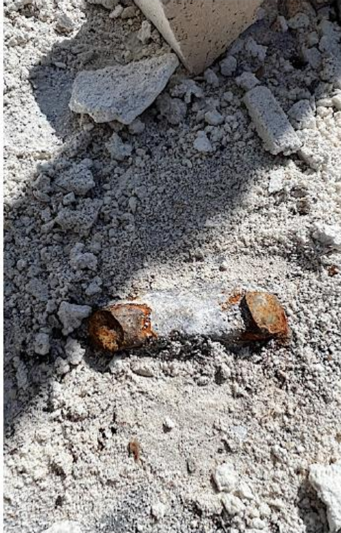
Photographie 6 Ancre brisée
