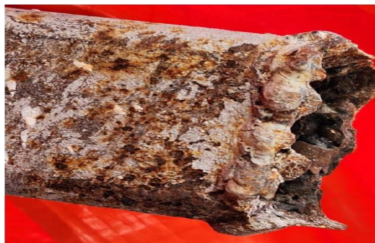
Fig. 25 - Membrane 4 soudée et rompue Source : CNESST
