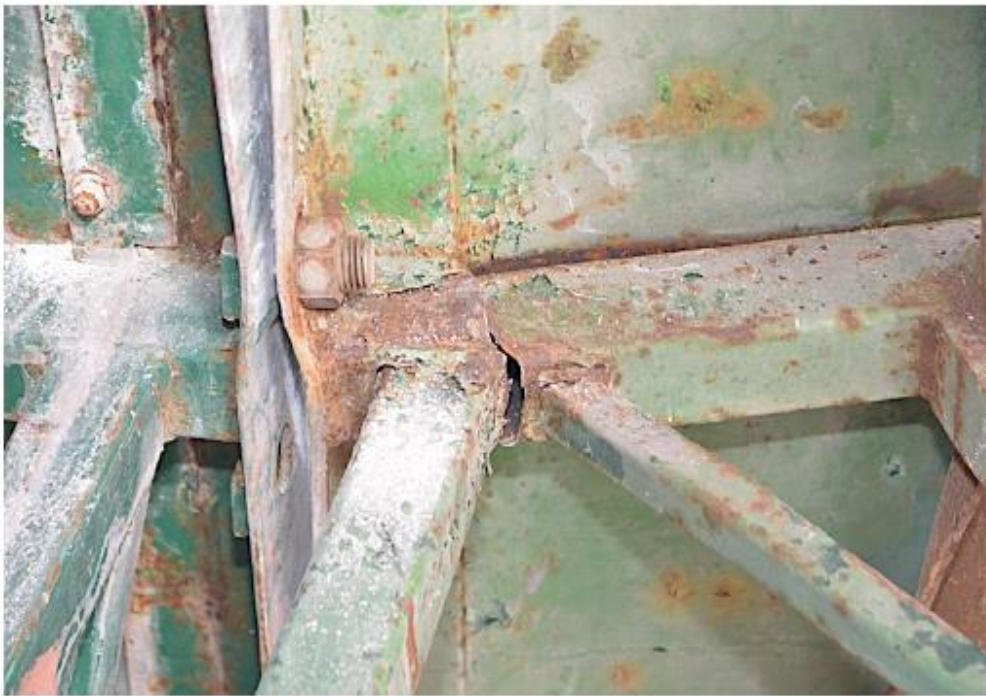
Photographie 10 Bris par surcharge
