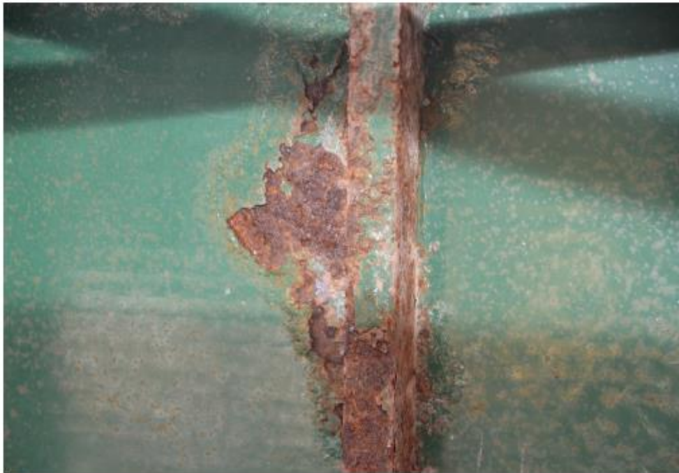
Photographie 8 Corrosion sur structure
