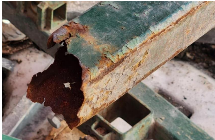
Fig. 23 - Membrane 2 corrodée et rompue Source : CNESST
