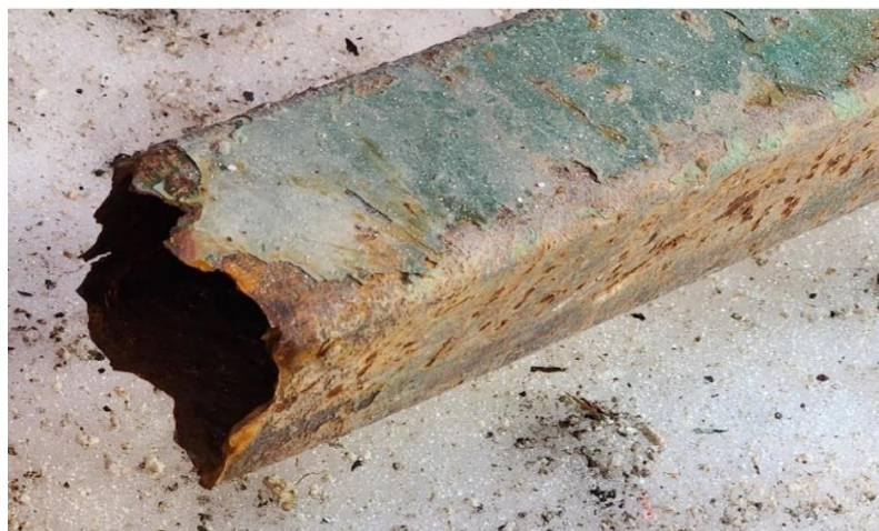
Fig. 22 - Membrure 1 corrodée et rompue
