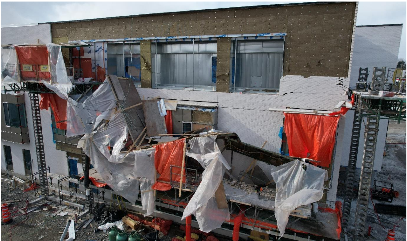
Figure 1 - Effondrement de l'échafaudage Source : CNESST
