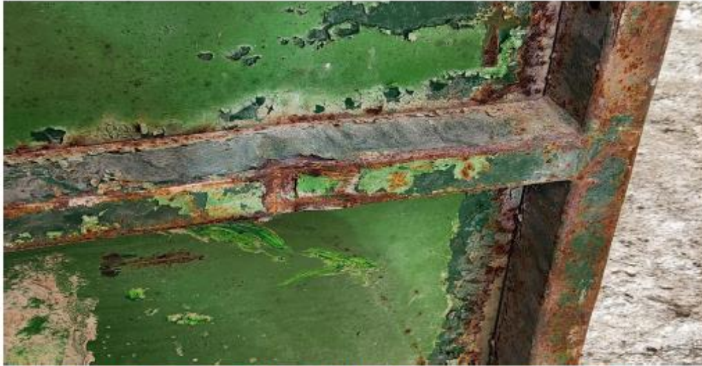
Photo 14 - Traces d'appui du pont modulaire sur l'unité mobile gauche (source CNESST)
