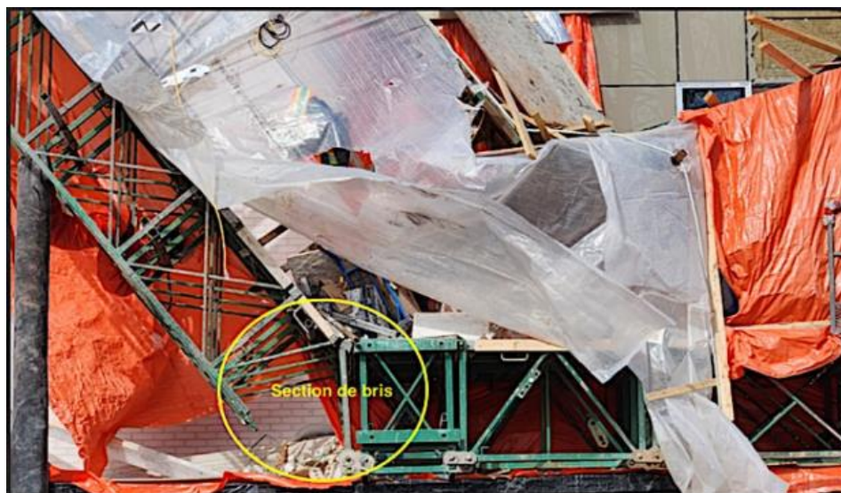
Fig. 20 - Zone de rupture Source : CEP Forensique
