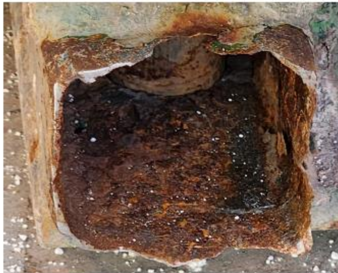
Photo 17 - Section transversale de la membrure 2 (source CNESST)
