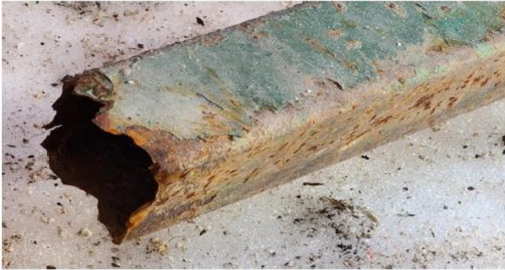
Photo 5 - Première membrure rompue avec des traces de corrosion avancée (source CNESST)
