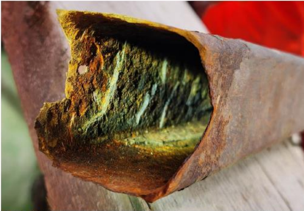
Photo 7 - Troisième membrure rompue avec des traces de corrosion avancée de l'intérieur (source CNESST)
