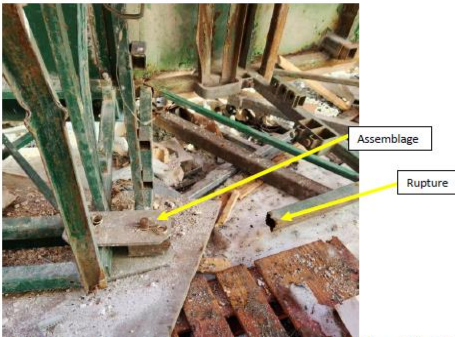
Photo 9 - Exemple de rupture d'une membrure inférieure. La rupture est à proximité de l'assemblage (source CNESST)
