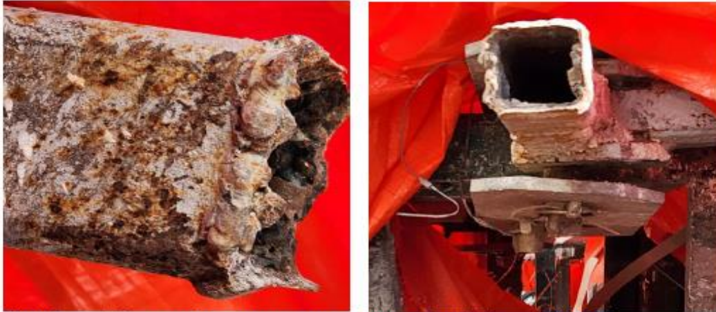
Photo 8 - Quatrième membrure rompue avec une soudure frontale (source CNESST)
