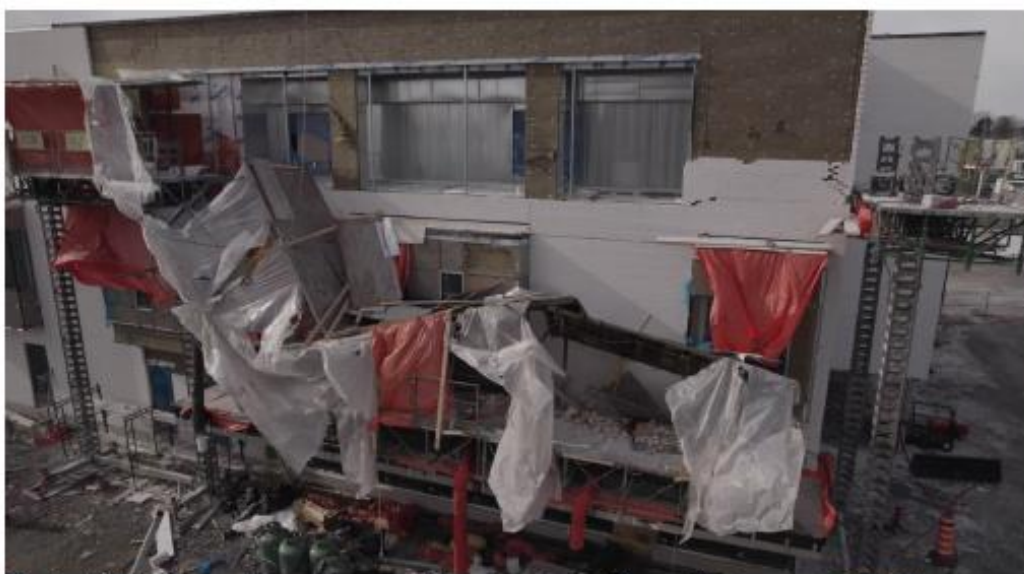
Photo 1 - Effondrement du pont en appui simple sur les unités mobiles (source CNESST)
