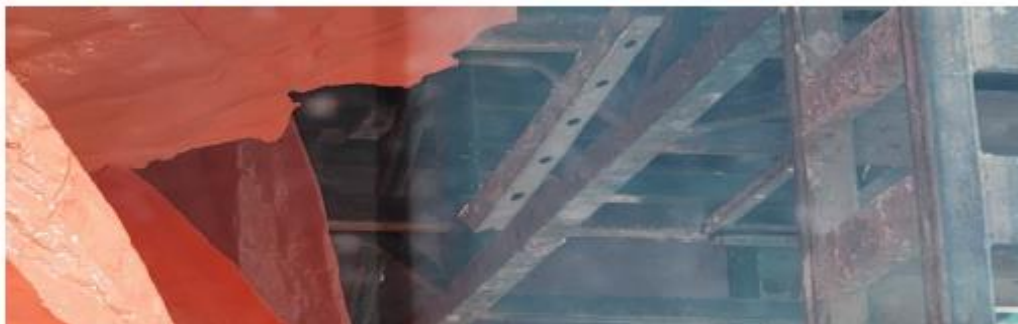
Photo 11 - Barre d'ancrage rompue de l'unité mobile gauche (source CNESST)
