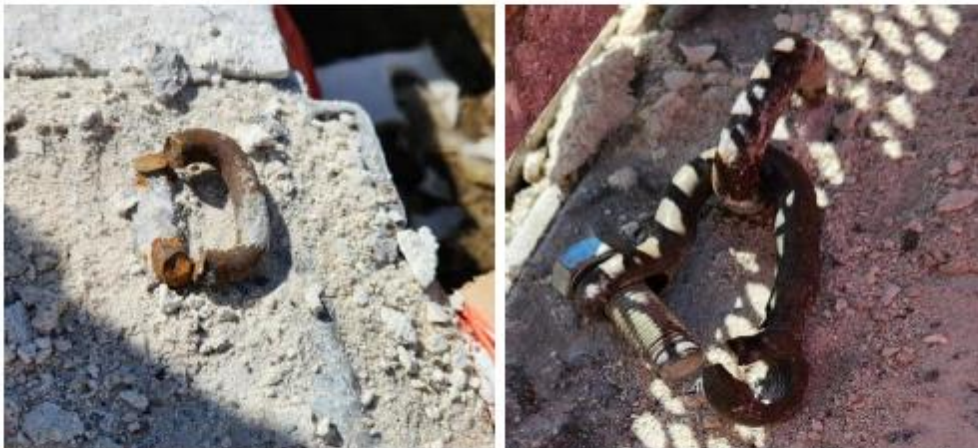
Photo 13 - Rupture des anneaux de sécurité sur la plateforme de l'unité mobile gauche (source CNESST)
