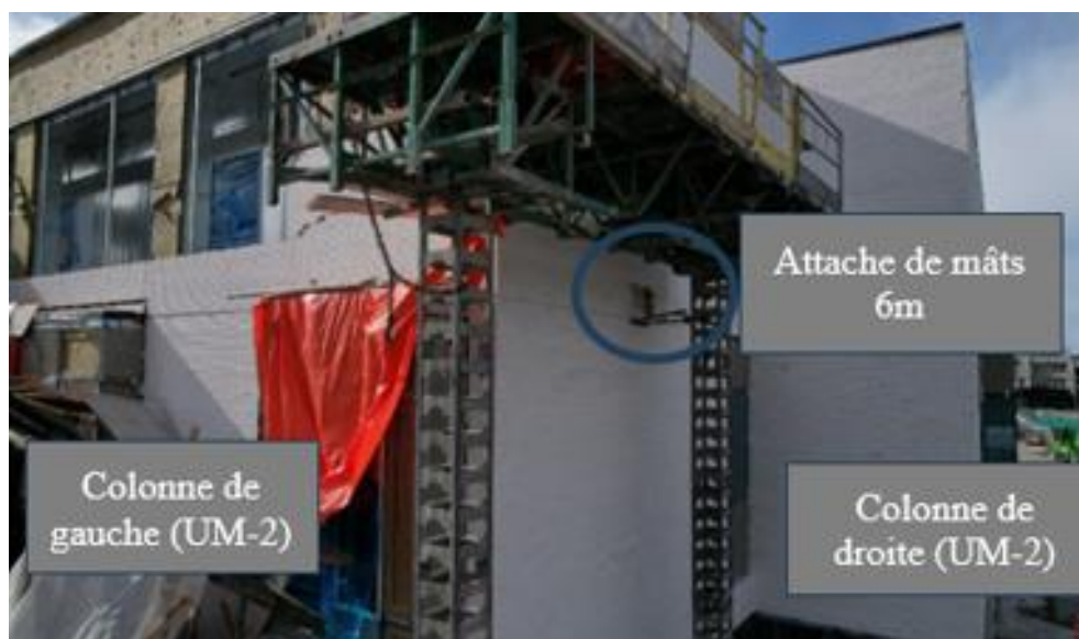
Fig. 9 - Amarrage de l'unité motorisée UM-2 Source : CNESST
