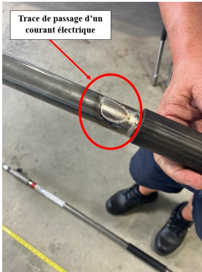
Fig. 8 - Trace de passage d'un courant électrique sur une rallonge du taille-haie Source : CNESST
