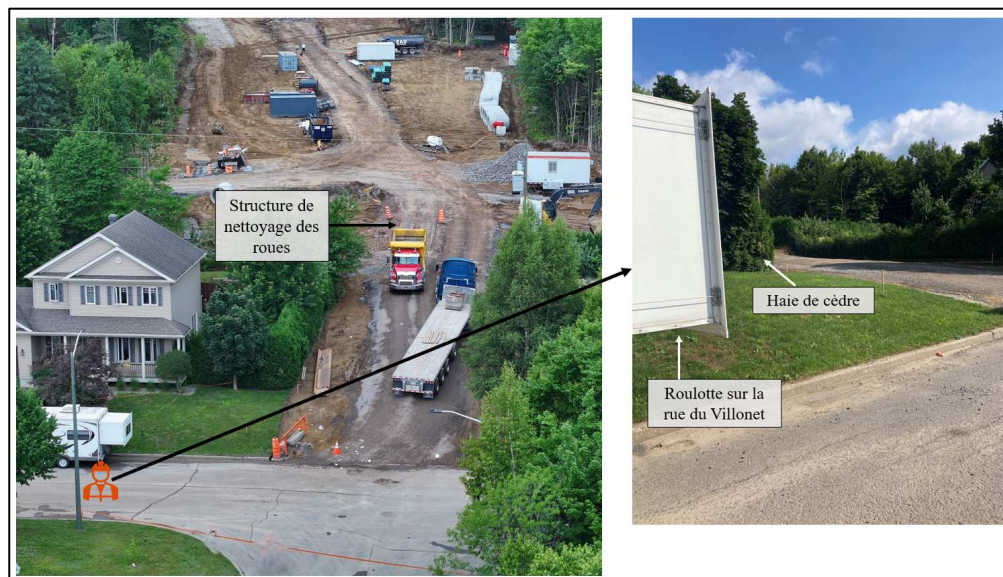
Fig. 29 – Vue de la sortie du chantier à partir de la position du signaleur
